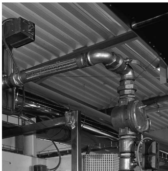
Компенсаторы на подающих трубопроводах зданий
